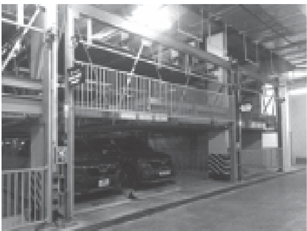
Hình 1. Hệ thống đỗ xe 3 tầng dưới hầm chung cư Vinhomes Symphony
